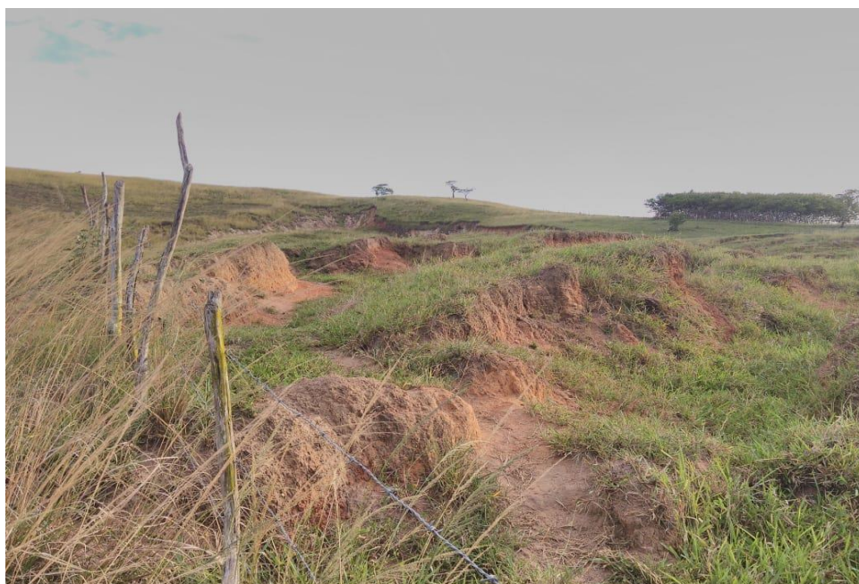
Figura 18 – Vista parcial de fissuras transversais. Fonte: Acervo dos autores, 2020.
