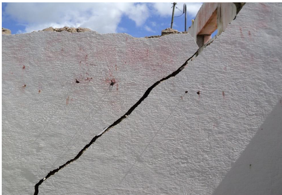
Figura 15 - Fissura em paredes de residências da comunidade. Fonte: Acervo dos autores, 2010.
