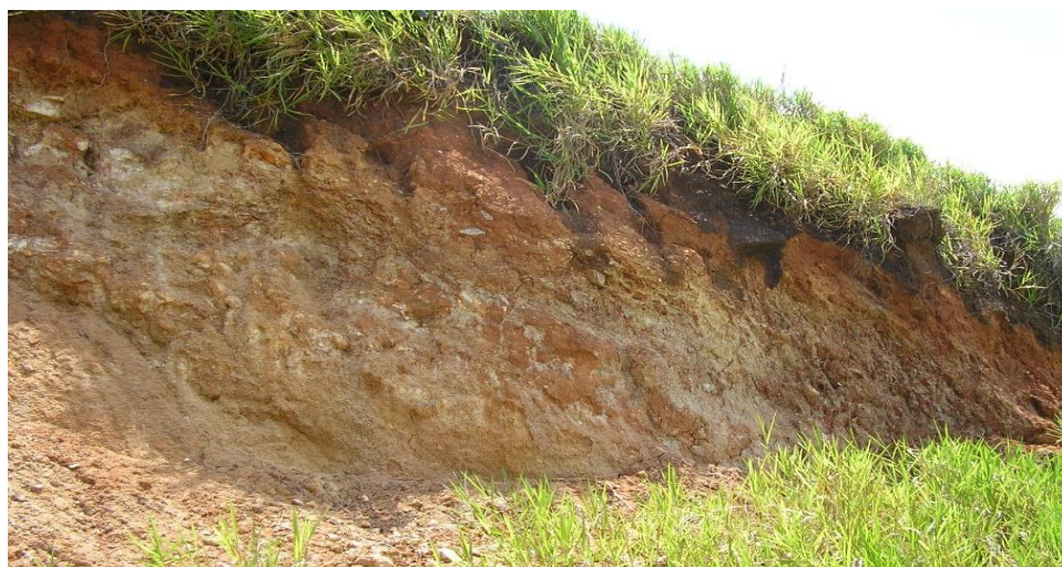
Figura 12 – Fissura mostra solo com forte intemperismo. Fonte: Acervo dos autores, 2010.
